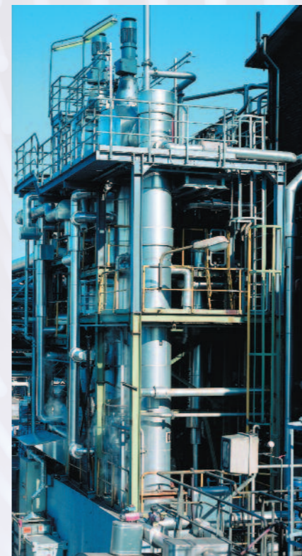
Двухступенчатая пленочная выпарная установка для концентрирования смолы
