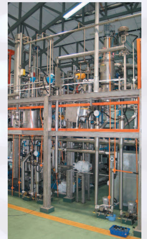
Полупромышленная установка для выпаривания метилового эфира
