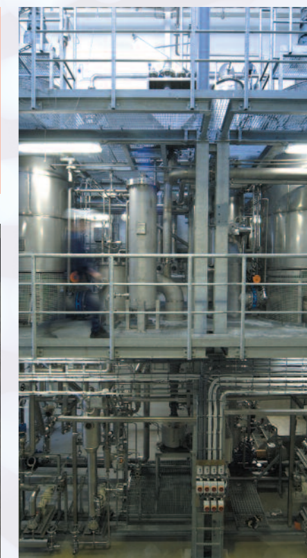
Установка по дистилляции омега-3 жирных кислот с системой вакуум-выпарных аппаратов
